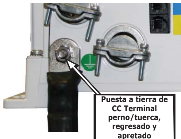
Ilustración 2-17, Cable a tierra de mayor sección conectado al serie MS-PE
